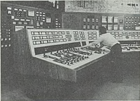
Pulpit mozaikowy montowany w nastawniach bloków energetycznych 200 MW
